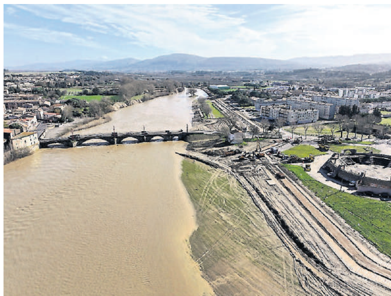
Le coût du réaménagement, 2,5 millions d'euros, est assumé à 50 % par l'État, 20 % la Région, 10 % le département et 20 % par le Smmar. / Photo Midi Libre
