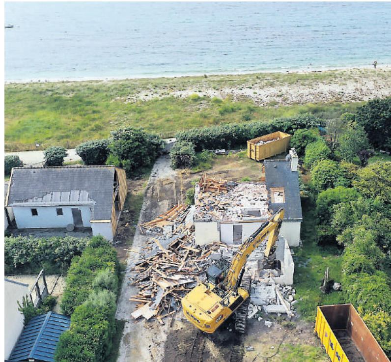
Sept maisons sont condamnées à disparaître, car trop exposées aux risques d'érosion côtière et de submersion marine. / Photo Nicolas Créach
